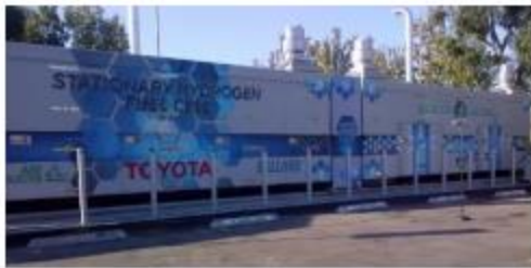
Ballard – 1.1 MW PEMFC – California, USA
